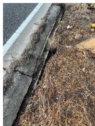
写真2 道路の地割れ
