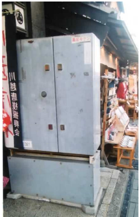
写真2 地上に置いた変圧器
