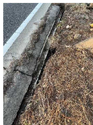
写真2 道路の地割れ
